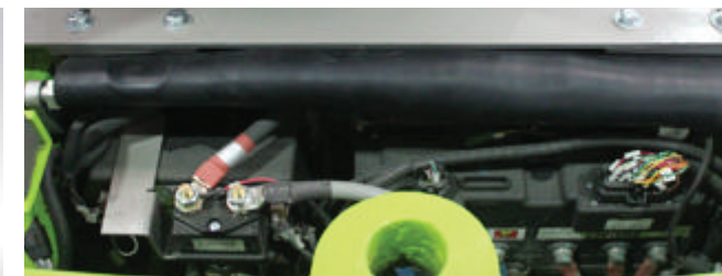
Denge ağırlığı kapağını açarak elektrik tesisatını kontrol edebilirsiniz.
